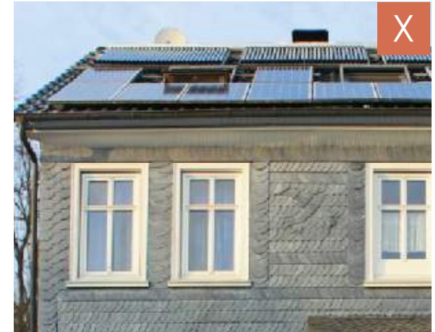
Abbildung 47: Verschiedene, auffällige, reflektierende Solaranlagen auf einer Dachfläche.
